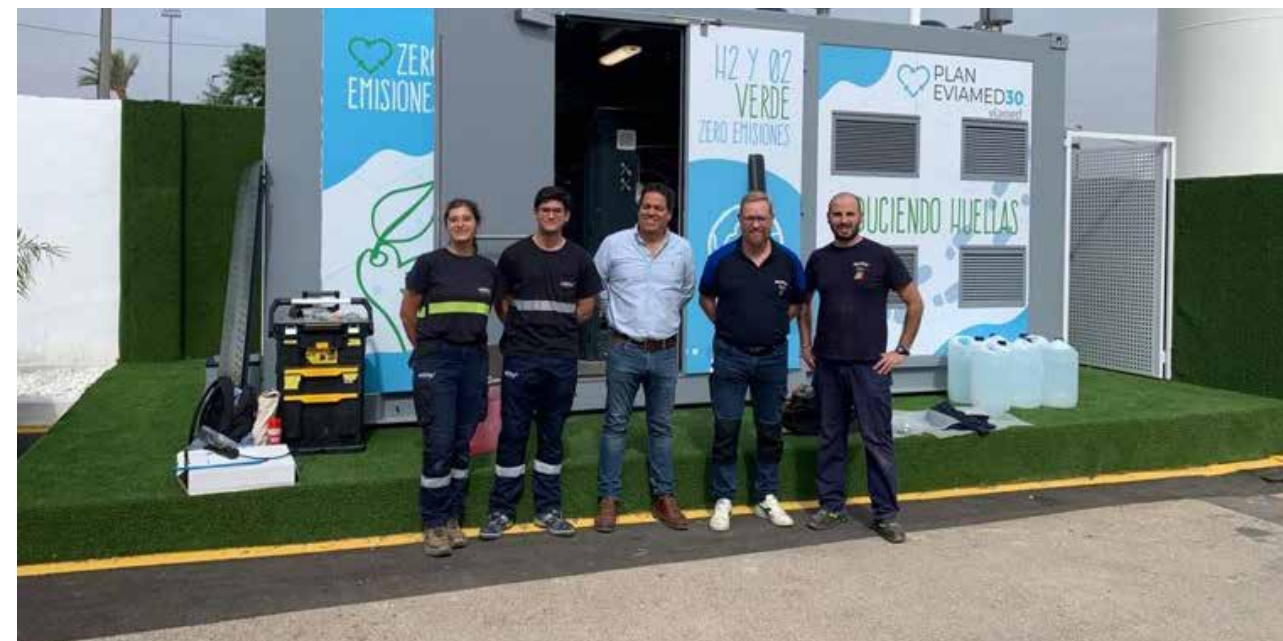
Imagen 14: ARPA. Planta de generación de hidrogeno para combustión y calentamiento de ACS en el Hospital San Jose en Murcia de Viamed.
