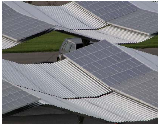
Instalación fotovoltaica. Fundación para el Desarrollo de las Nuevas Tecnologías del Hidrógeno en Aragón.
