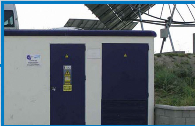
CENTRO DE INTERCONEXIÓN ELECTRICAL SUBSTATION
